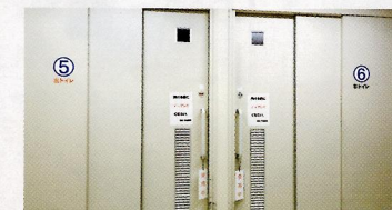
左右障害別トイレ10年以上前の設置当時からあり、患者への真の配慮がうかがえる。
